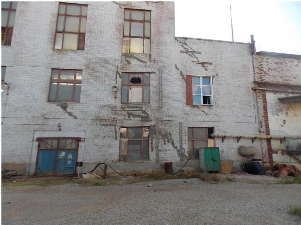
Фото 1. Трещины в наружной стене м/о 23 1 -35 1 /Л 1
